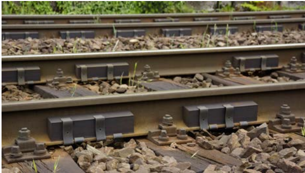
Abbildung 55: Schienenstegdämpfer im Verlauf der Elbtalstrecke.
