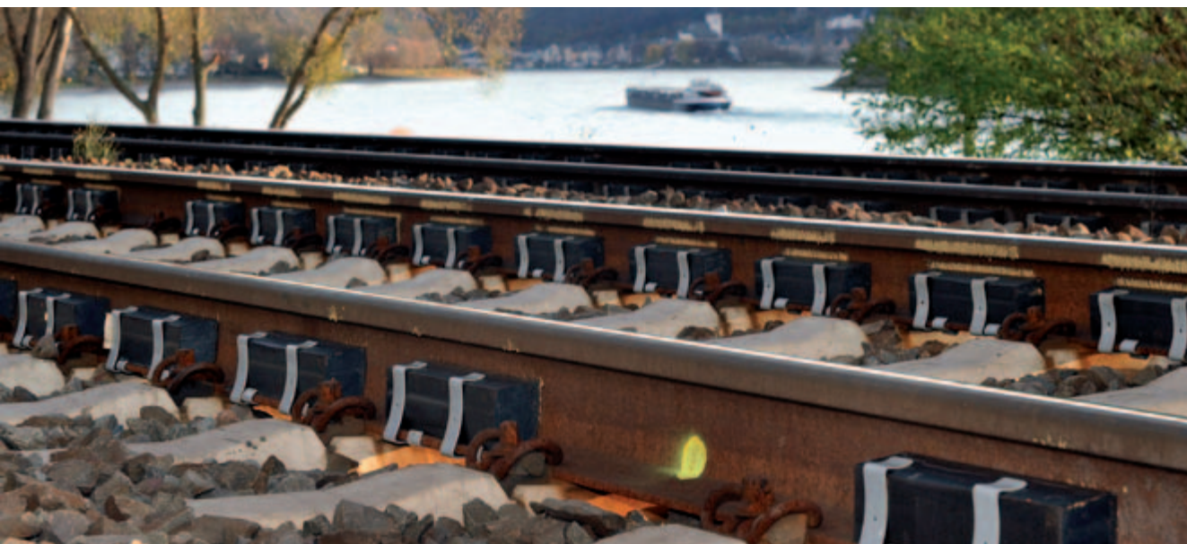
Schienensteg- bedämpfer bei einem Regel- oberbau mit Schotterbett im Mittleren Rheintal
